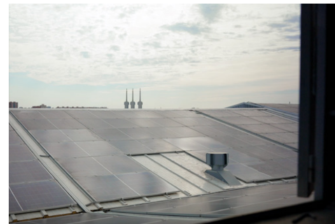
Paneles fotovoltaicos, BioSystems Barcelona.
